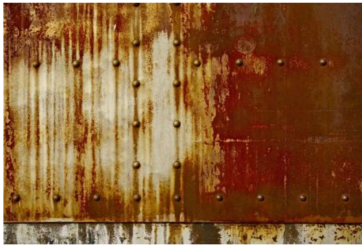
Figuur 1: Uniforme corrosie
