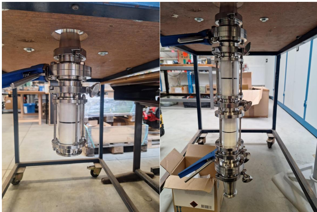
Figuur 44: filter gemonteerd
