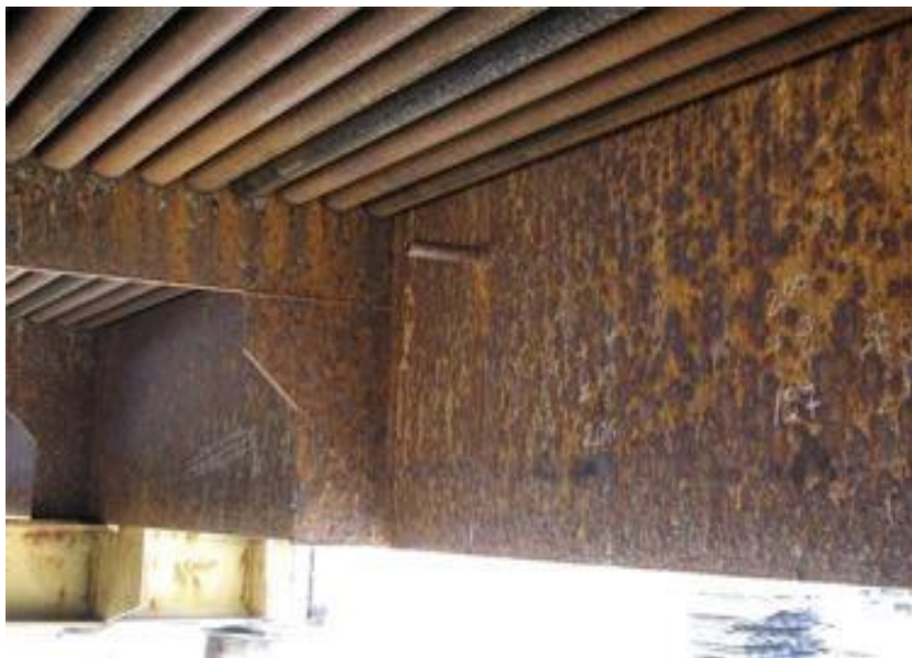
Figuur 2 Algemene corrosie (roesten) van de stalen ketelconstructie
