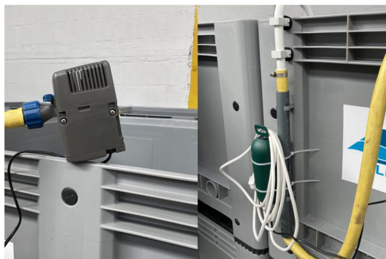
Figuur 40 Detail pomp (links) en stroomvoorziening (rechts) Bron: (K. De Baere, persoonlijke communicatie, 26 april 2020b)
