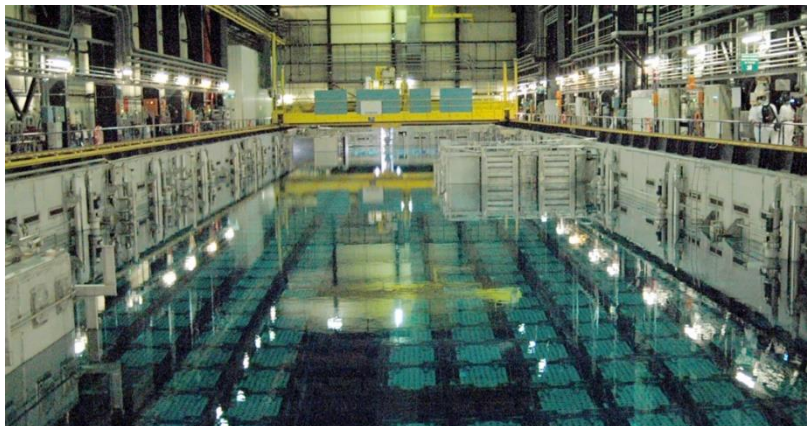
Figure 32 Piscine de stockage des matières fissiles irradiées Source : Philippe Collet, IRSN (2018)
